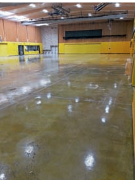
Pogled na uničena tla v novi telovadnici FOTO: ANDREJ JELOVČAN
